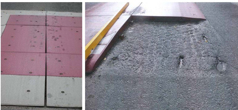
Figure 108 : Illustration de phénomènes de déplacement des éléments de coussins en caoutchouc et de dégradation du revêtement
