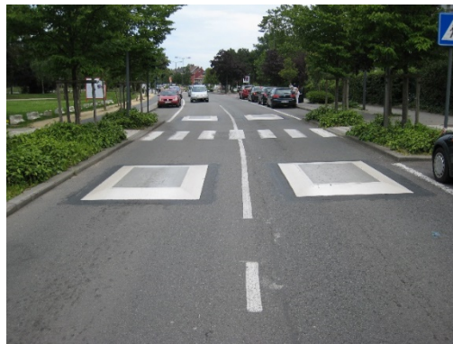
Figure 70 : Installation de coussins côte-à-côte à proximité d'un passage piéton sur une chaussée dont la largeur est comprise entre 6 m et 7,2 m
