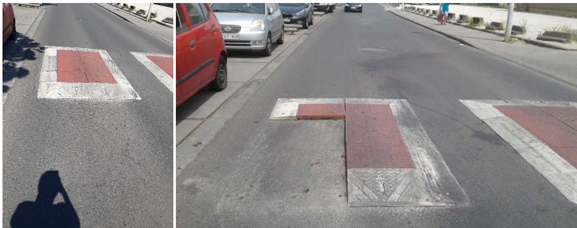
Figure 109 : Illustration d'un phénomène de détachements des éléments de coussins en caoutchouc (quai de l'Industrie à Anderlecht ; photos prises les 14/05/2020 et 04/06/2020 ; installation en 2018) – Dans le cas présent, la largeur de la chaussée est trop réduite pour respecter les règles en matière de positionnement transversal ; ceci peut avoir un impact sur les sollicitations apportées aux coussins.
