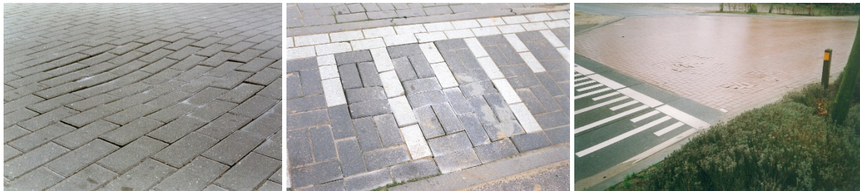
Figure 80 : Illustration de dégradations induites par des efforts dynamiques
